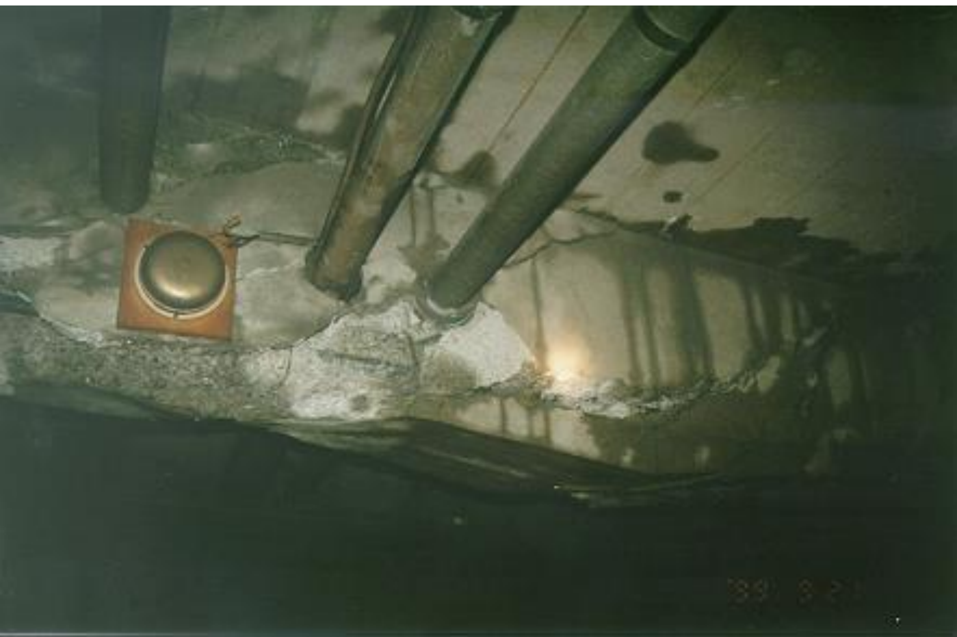
台北市東星大樓921地震發生後地下室照片
